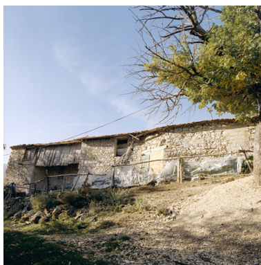
Vue générale de la façade postérieure depuis l'est. Phot. Françoise Baussan IVR93_20060402390XE
