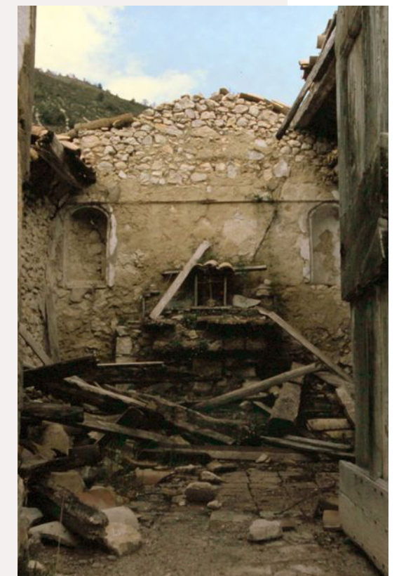
L'intérieur de la chapelle d'Ourges en 1984 (Photographie J.P Pinatel publiée dans dignois.fr )
